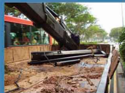
卡车上的起重机吊臂在碧山路撞毁行人天桥后受损的情形。
